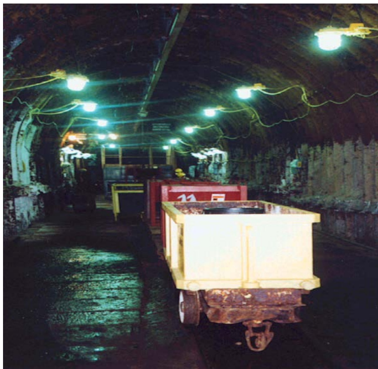
Fot. 3. Widok ogólny komory dozowania sorbentu w kopalni „Piast”
