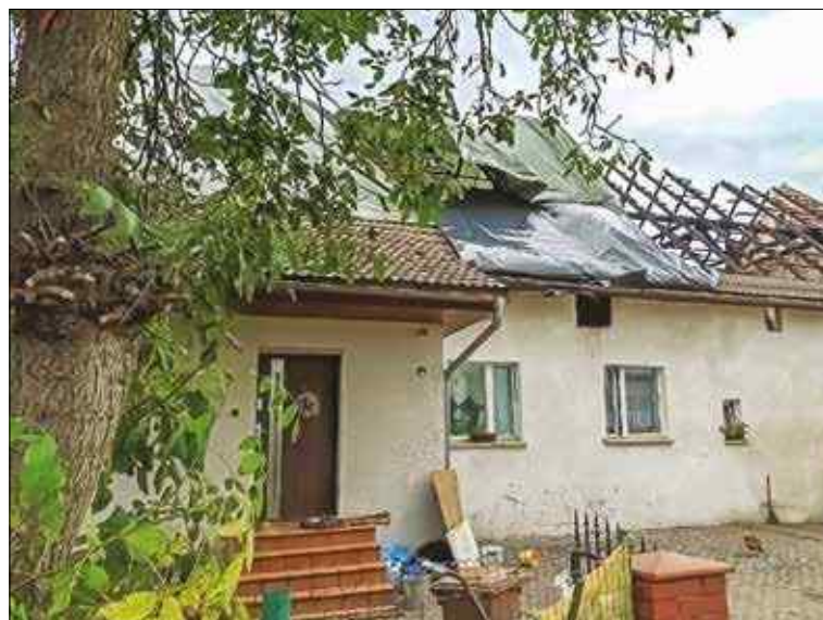
Po pożarze strażacy zafolowali dach nad częścią mieszkalną
