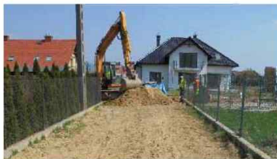
Bystra, rejon ul. Skośnej
