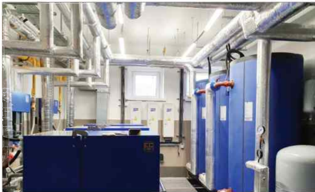
Nowa instalacja wysokosprawnej kogeneracji, dla ogrzewania i ciepłej wody użytkowej
