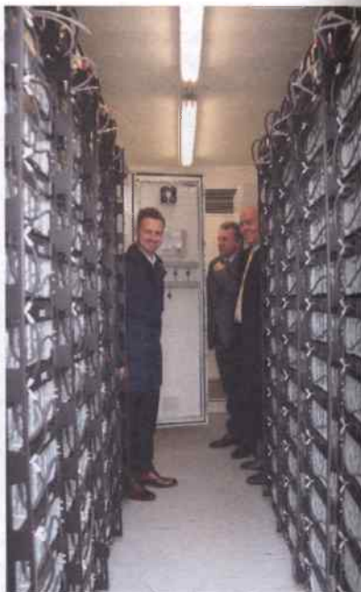
Dzięki „magazynowi energii” możliwe jest korzystanie z prądu nawet w nocy!
