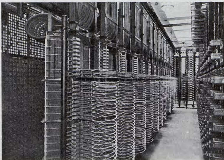
Wnętrze automatycznej centrali telefonicznej Ericssona w Stockholmie.
