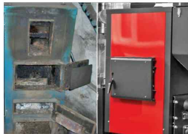
Kopciuchy przez wiele lat najchętniej były wymieniane przez właścicieli domów jednorodzinnych właśnie na nowoczesne kotły węglowe. Od 2022 zniknie możliwość pozyskiwania na taką wymianę dotacji.
