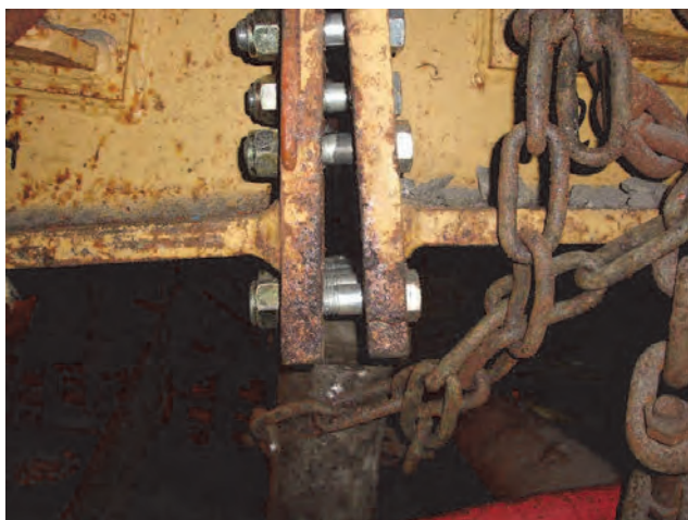
Fot. 5.5. Rozwarcie blach belek wspornika W2 i W3 (widoczne nowe śruby i nakrętki po wymianie)
