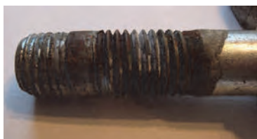
Fot. 5.6. Uszkodzona śruba M24
