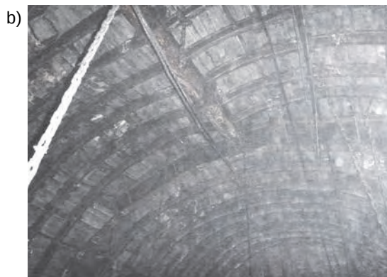
Fot. 6.11. Obudowa odgałęzienia pochylni w Zakładzie Górniczo-Energetycznym „Sobieski-Jaworzno III” (ZG „Sobieski”): a – konstrukcja w trakcie próbnego montażu u producenta (Stałęga 1999), b – belka stropowa łącząca portale i portal pomocniczy
