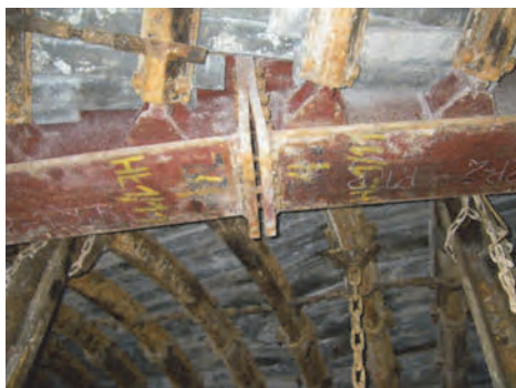
Fot. 5.2. Zerwane nakrętki w połączeniach śrubowych belek W2 i W3
