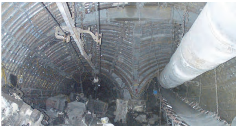
Fot. 6.2. Obudowa odgałęzienia przekopu kierunkowego pod pokładem 510, poziom 774 m z przekopem odstawczym 774/585 w końcowym etapie zabudowy w wyrobisku
