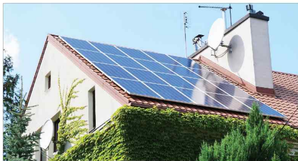
Instalacje fotowoltaiczne stają się coraz powszechniejsze. Okazuje się, że jeśli na stosunkowo małym obszarze jest ich dużo, to lokalna sieć energetyczna może mieć problem z odbiorem produkowanej przez instalacje energii.
