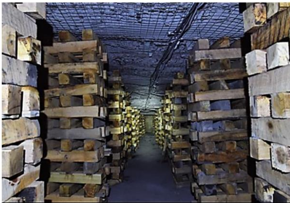
Fot. 3.2. Chodnik wykonany w samodzielnej obudowie kotwowej wzmocniony kasztami drewnianymi [85]
