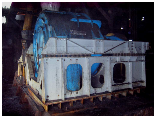
Rys.6. Wirówka WOK 1.5 i WOW 1.3 (w tle) zainstalowane w KWK „Budryk”
