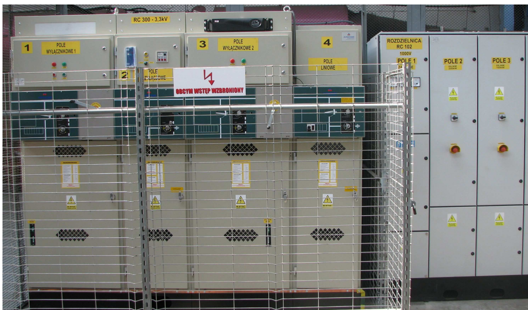
Rys.5. Zmodernizowana instalacja elektryczna na hali badawczej [źródło: fot. KOMAG]
