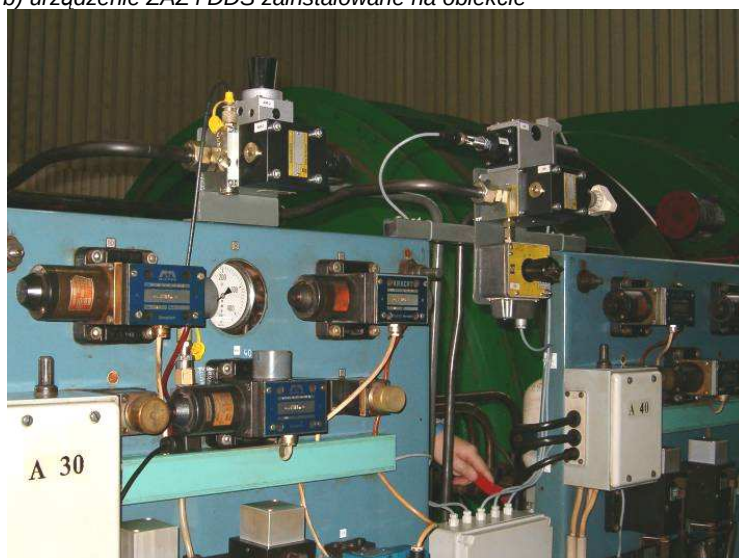
b) urządzenie ZAZ i DDS zainstalowane na obiekcie
