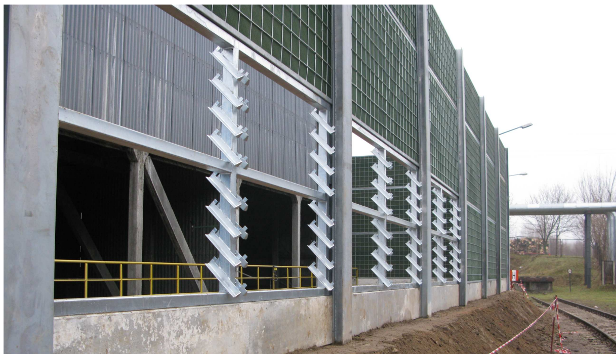
Rys.2. Ekran akustyczny w rejonie chłodni wyparnej turbiny [13]
