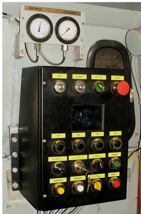
Rys.8. Nowoczesny pulpit sterowniczy MPS-1 zabudowany w kabinie lokomotywy (fot. KOMAG)
