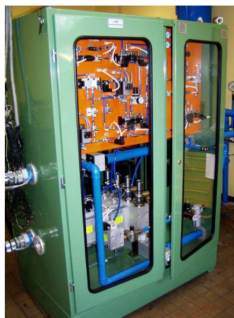
b) szafa wyposażenia pneumatycznego zespołu ZSHP-A1
