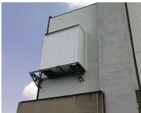
Rys.17. Tłumik zabudowany na elewacji budynku nr VII w KWK „Jankowice”
