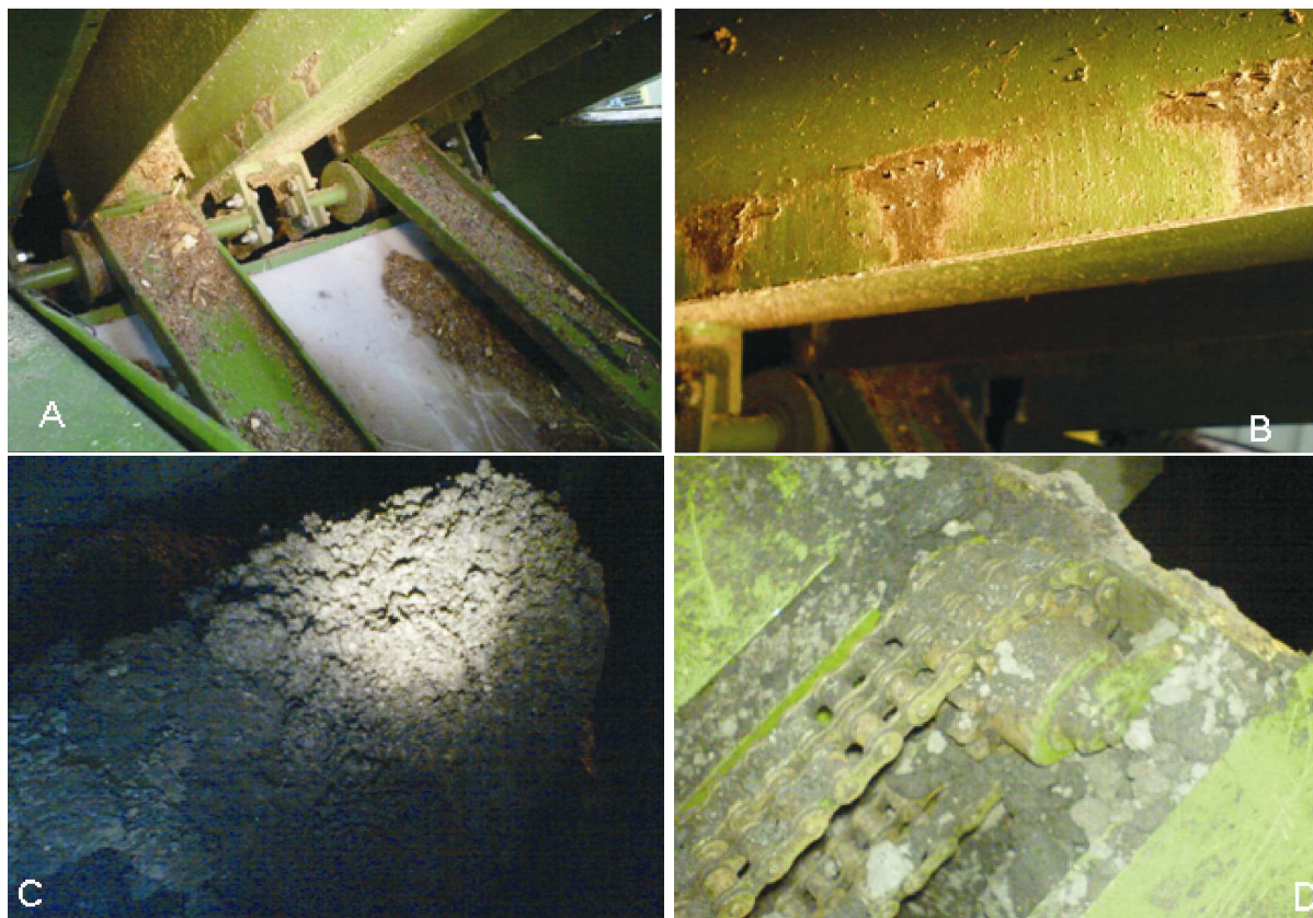
Rys.4. Typowe uszkodzenia próbobiornika: A – zanieczyszczenie materiałem pobieranym przewodników, B – korozja elementów nośnych, C – całkowite zasypanie urządzenia, D – oblepienie łańcucha napędowego zawilgoconym pyłem [8]
