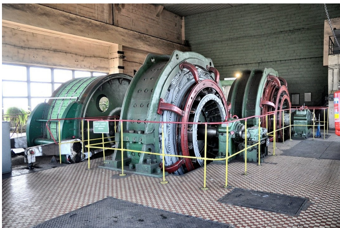
92. Maszyny wyciągowe na szczycie wieży.
