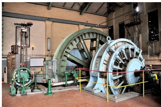
39. Elektryczna maszyna wyciągowa z tarczą Koepe.
