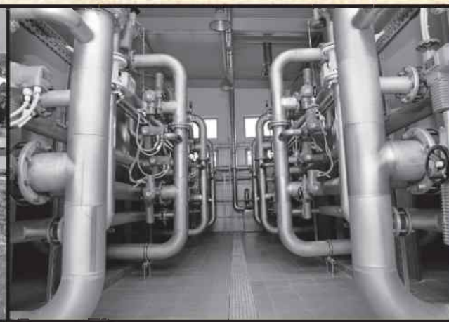
Stacja Uzdadniania Wody
