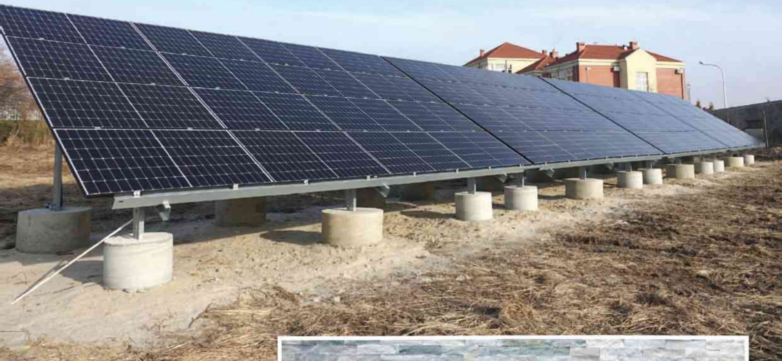
Panele fotowoltaiczne na terenie DPS Maria w Korfantowie
