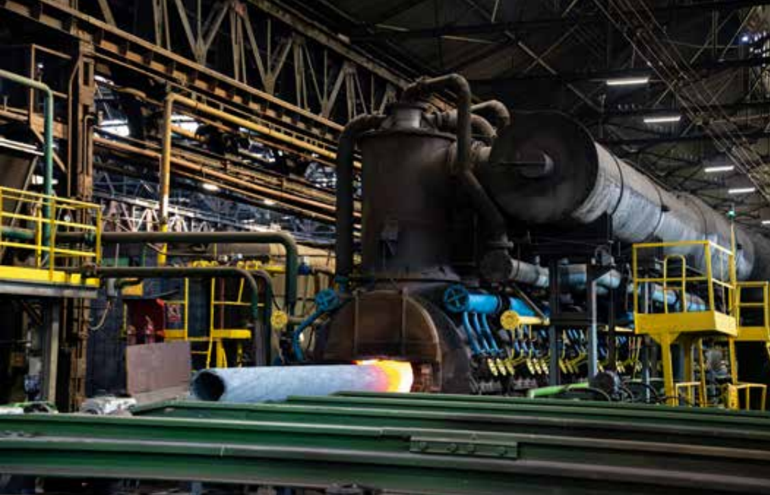
Powyżej: piec dwunastosekcyjny do obróbki cieplnej gotowych rur, 2023 rok, fot. Bernadeta Maksysz.
