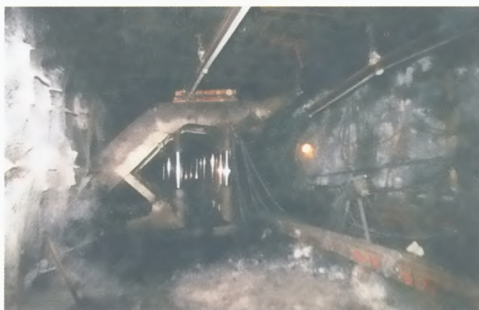
Rys.6. Widok obudowy zmechanizowanej zabudowanej w przecince ścianowej 4/V
