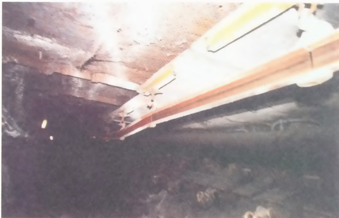
Rys.11. Rozwiązanie zamocowania szyny jezdnej transportowej do końca stropnicy obudowy zmechanizowanej
