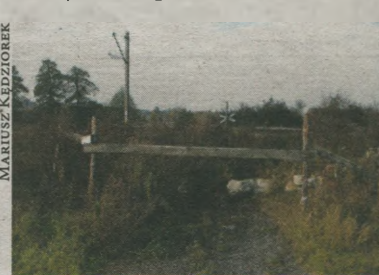
Z powodu zniszczenia przepustu trzeba było zamknąć przejazd kolejowy
