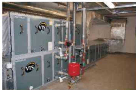
Stacja wentylacji mechanicznej z systemem odzysku ciepła poprzez wymienniki. Powietrze jest podgrzewane, chłodzone oraz filtrowane poprzez system filtrów.
