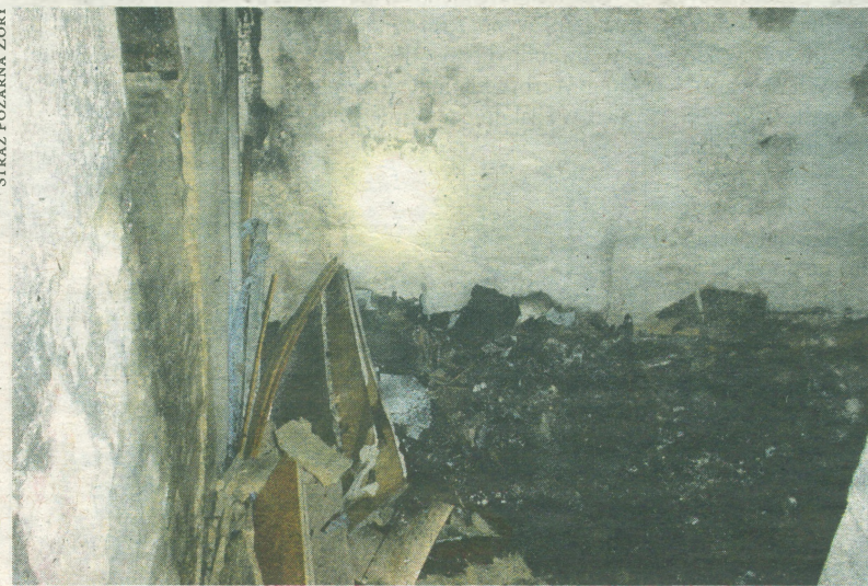
Tak po pożarze wygląda piwnica w feralnym bloku
