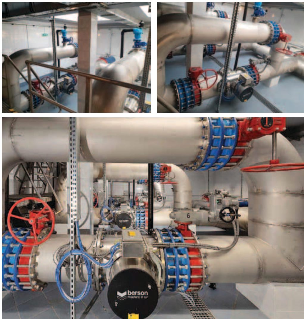
Rysunek 62. Widok instalacji lamp UV zabudowanych w 2013 r. w komorze podziemnej na ujęciu SOŁA III w Kobiernicach. Stan z maja 2015 r. [źródło: materiały archiwalne AQUA S.A.].
