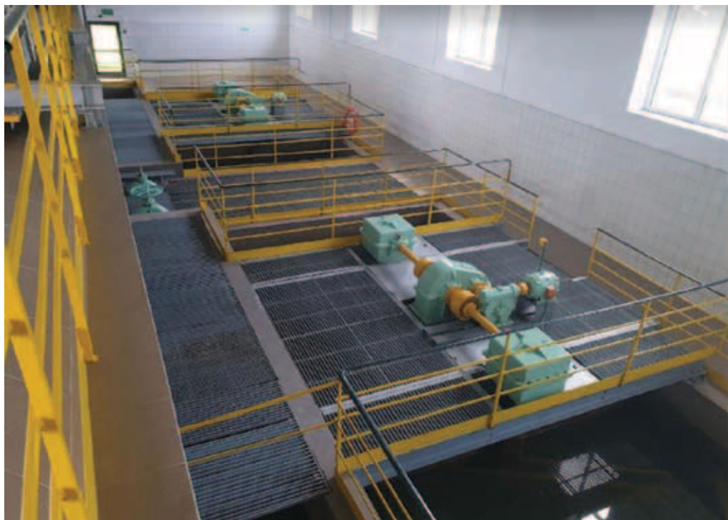
Rysunek 53. Widok na komory wolnego mieszania w hali koagulacji po modernizacji z 2008 r. [źródło: materiały archiwalne AQUA S.A.].
