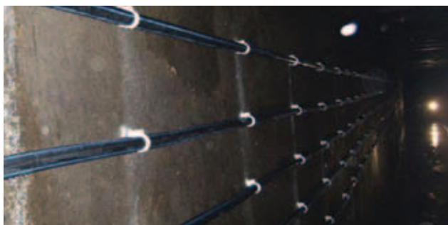
Rysunek 100. Orurowanie instalacji dolnego źródła ciepła w zbiornikach pokoagulacyjnych na SUW SOŁA I [źródło: materiały archiwalne AQUA S.A.].
