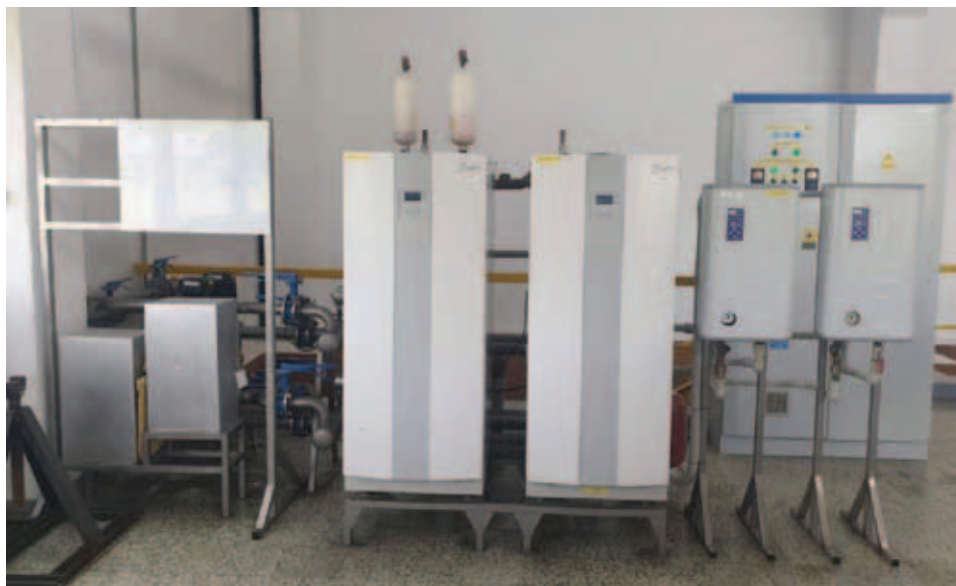
Rysunek 103. Widok na stację pomp wykonaną na pompowni G w Kobiernicach z czerwca 2019 r. [źródło: materiały archiwalne AQUA S.A.].
