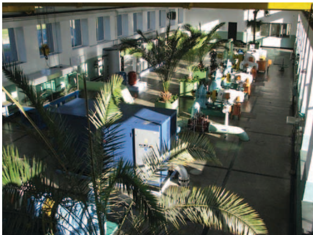
Rysunek 71. Widok od strony sterowni na pompownię wody Z na stacji wodociągowej SOŁA I w Kobiernicach [źródło: materiały archiwalne AQUA S.A.].
