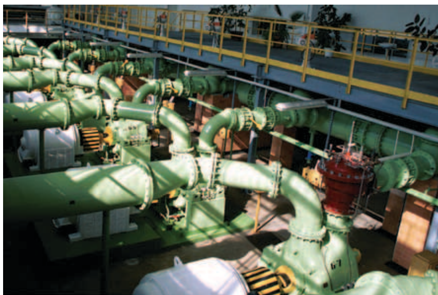
Rysunek 11. Pompownia G w Kobiernicach. Na pierwszym planie widoczny testowany w 2000 r. zawór membranowy CLA-VAL typu kąтового zabudowany na wypływie z pompy dwustrumieniowej typu 35W50 Warszawskiej Fabryki Pomp. Po przeprowadzeniu audytu w 2000 r. przez WS ATKINS pompa została zmodernizowana przez Świdnicką Fabrykę Pomp [źródło: materiały archiwalne AQUA S.A.].
