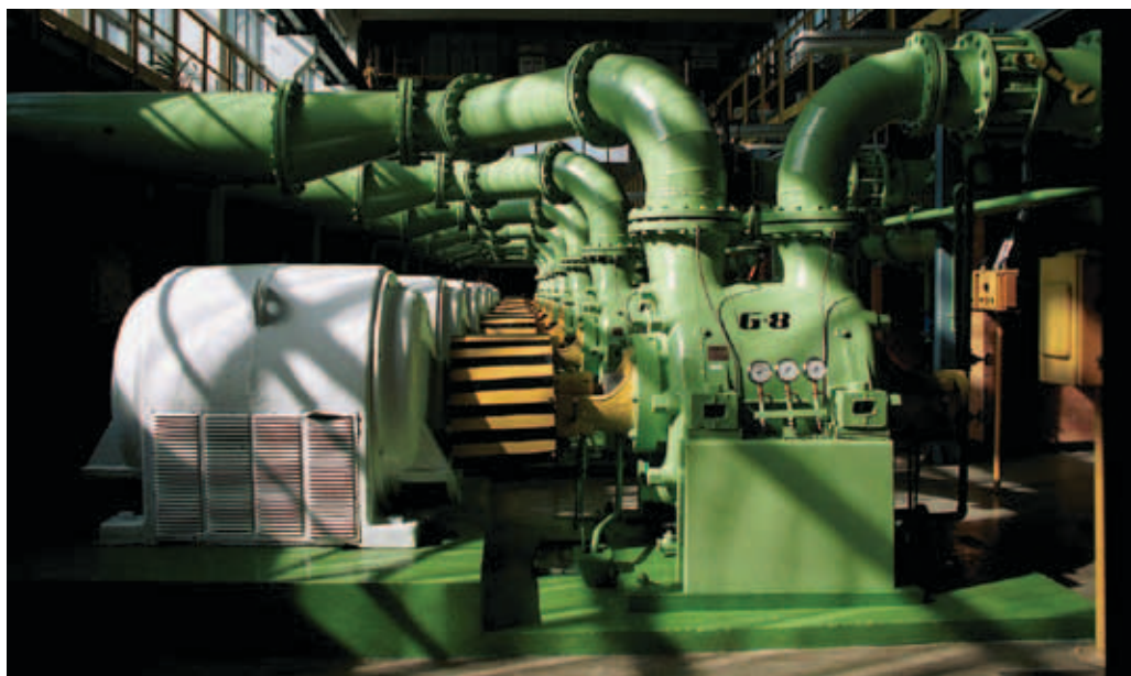
Rysunek 32. Pompownia wysokiego ciśnienia G zlokalizowana na terenie ujęć infiltracyjnych SOŁA III/1 uruchomiona w 1984 r. [źródło: materiały archiwalne AQUA S.A.].
