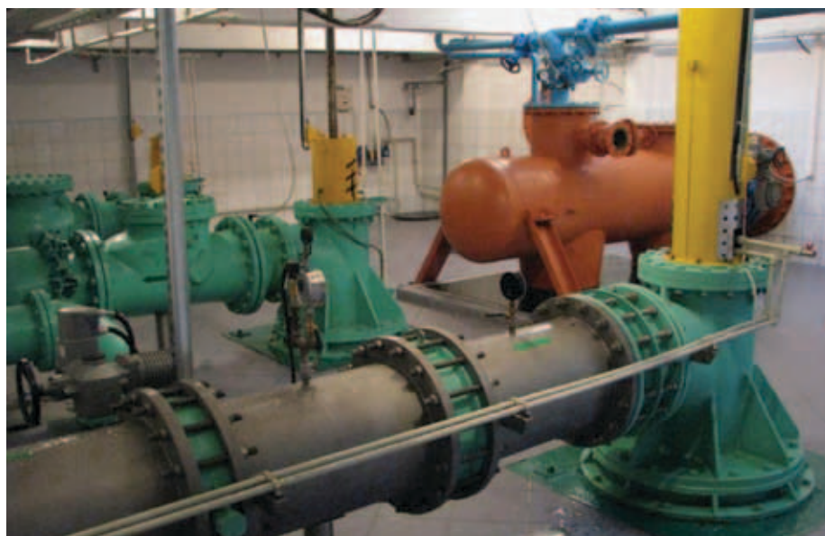
Rysunek 88. Pompownia niskiego ciśnienia B – poziom pomp. Na pierwszym planie nowa pompa 30D22. W głębi głowica odpowietrzająca na lewarze grawitacyjnym Steinwender'a [źródło: materiały archiwalne AQUA S.A.].
