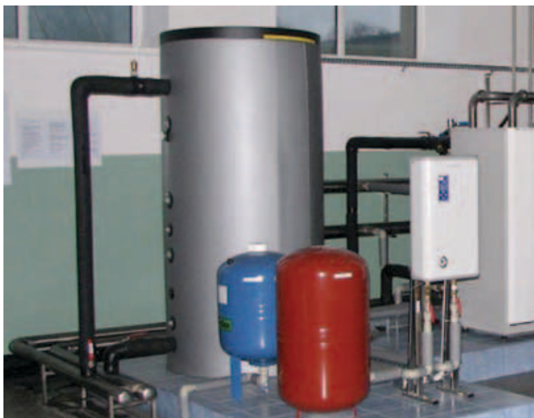
Rysunek 99. Zbiornik wody lodowej i awaryjny kocioł elektryczny zainstalowany na SUW SOŁA I [źródło: materiały archiwalne AQUA S.A.].
