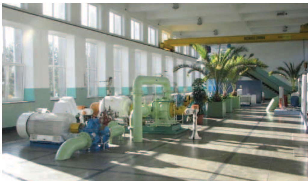
Rysunek 72. Na pierwszym planie pompa WEIR zabudowana w 2000 r. ze środków Banku Światowego w miejsce pompy W20T3, kolejna pompa to pompa W20T3 [źródło: materiały archiwalne AQUA S.A.].
