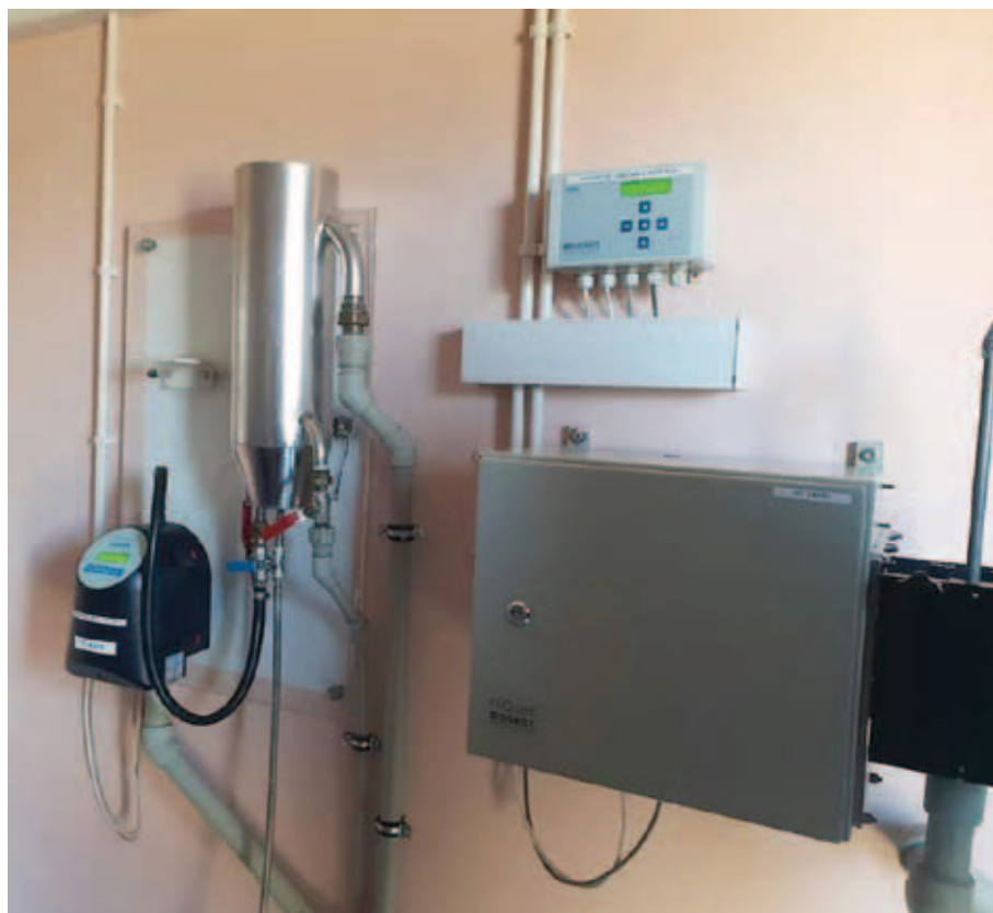
Rysunek 65. Widok CCP (Critical Control Point) – jednego z wielu wykonanych na sieci wodociągowej AQUA S.A. punktów stałej kontroli w czasie rzeczywistym jakości wody dostarczanej odbiorcom. CCP wykonywane są w celu zapewnienia zgodności z normą ISO PN/EN – 22000 [źródło: materiały archiwalne AQUA S.A.].
