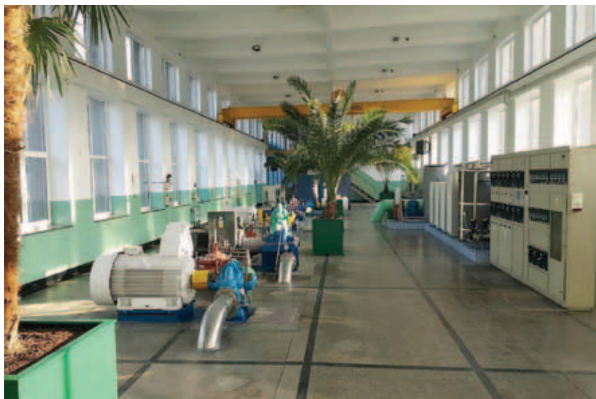
Rysunek 10. Widok na halę pompowni Z wraz z rozdzielnią energetyczną 6 kV i urządzeniami pomp ciepła zainstalowanych na SUW SOŁA I w Kobiernicach [źródło: materiały archiwalne AQUA S.A.].
