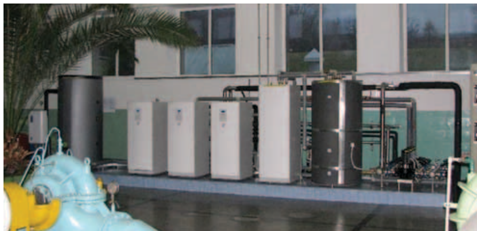
Rysunek 98. Widok instalacji pomp ciepła i wody lodowej w pomieszczeniach pompowni Z na SOŁA I w Kobiernicach [źródło: materiały archiwalne AQUA S.A.].
