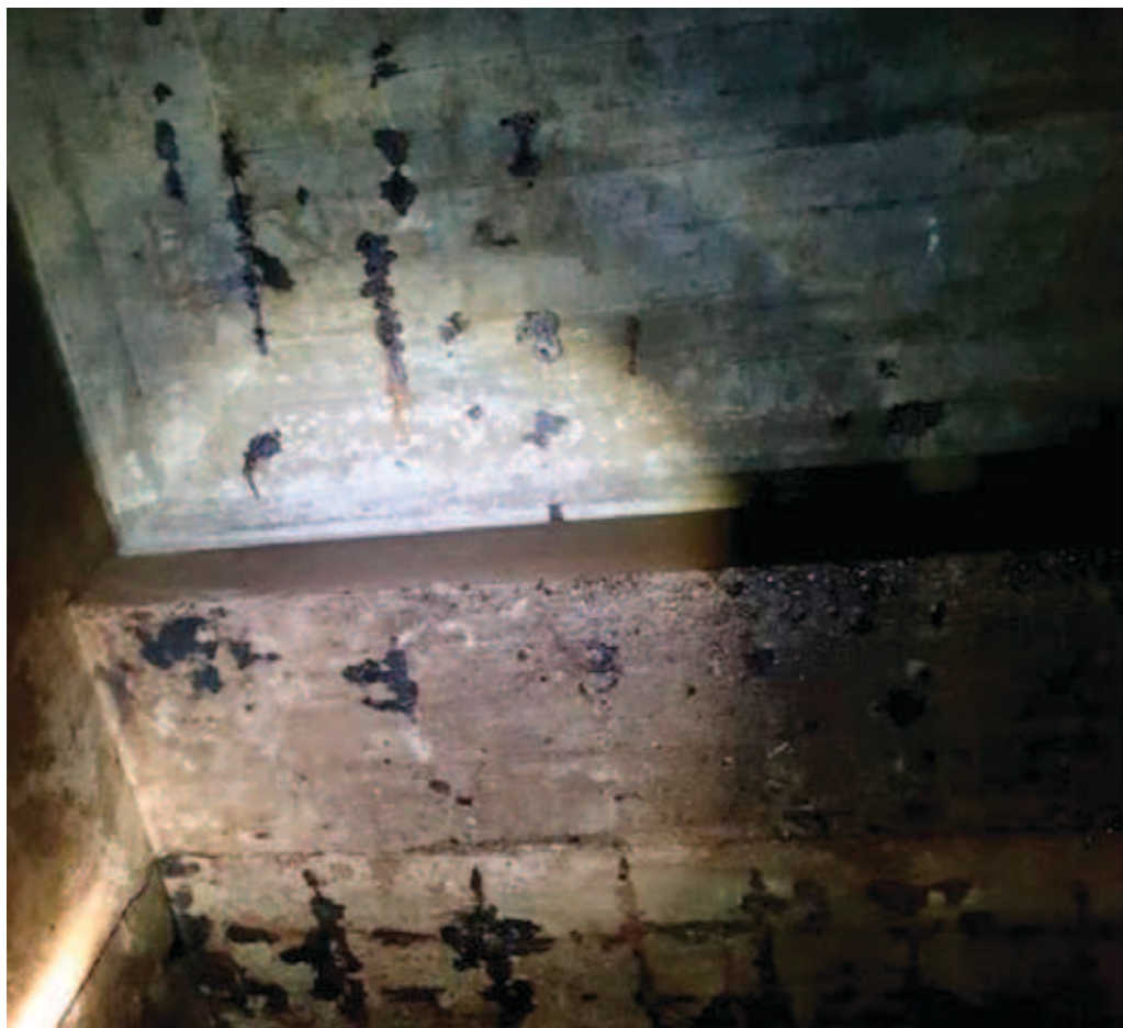
Rysunek 13. Widok skorodowanego żelbetowego stropu zbiornika podfiltrowego wody na SUW SOŁA I w Kobiernicach (widok przed wykonaną w 2020 r. renowacją ścian żelbetowych zbiornika i wodociągów) [źródło: materiały archiwalne AQUA S.A.].
