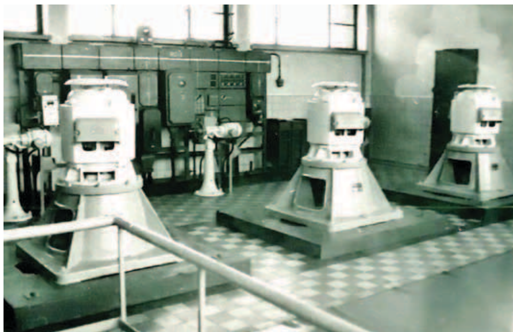
Rysunek 74. Widok pomp diagonalnych zabudowanych pierwotnie w pompowni niskiego ciśnienia dla potrzeb poboru wody z lewara A ujęcia infiltracyjnego SOŁA II w Kobiernicach (lata 60. XX w.) [źródło: Wojciechowski, 1974].
