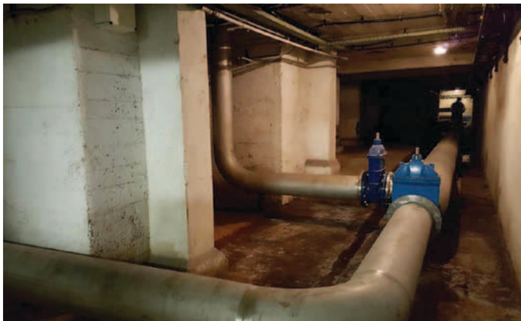
Rysunek 93. Przewody wodociągowe umieszczone w podziemiach hali pomp pompowni Z po przebudowie i wymianie armatury [źródło: materiały archiwalne AQUA S.A.].
