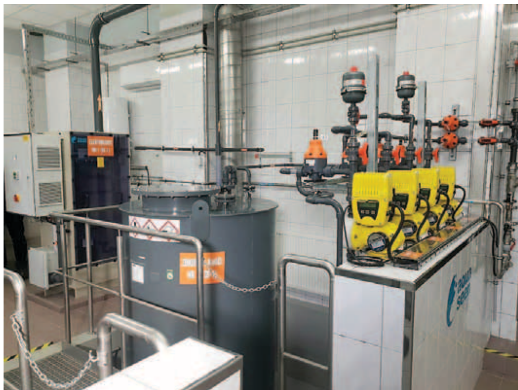
Rysunek 58. SUW SOŁA I w Kobiernicach. Na pierwszym planie zbiornik retencyjny na podchloryn sodu wytworzony w procesie elektrolizy oraz pompki dozujące podchloryn do sieci wodociągowej [źródło: materiały archiwalne AQUA S.A.].
