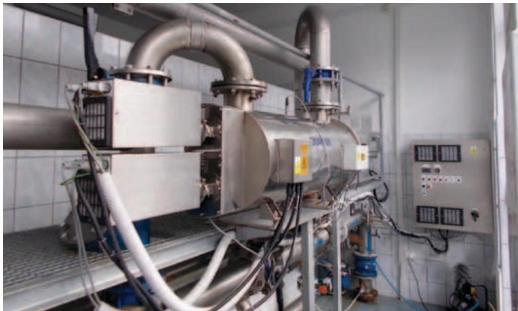
Rysunek 60. Widok pierwszej lampy QUAY Technologist zainstalowanej na SUW w Szczyrku [źródło: materiały archiwalne AQUA S.A.].
