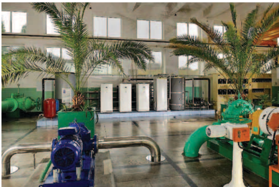
Rysunek 66. Wyposażenie hali pompowni Z na stacji wodociągowej SOŁA I w 2015 r. Na pierwszym planie pompy wodociągowe, w głębi kotłownia oparta o technologię pomp ciepła [źródło: materiały archiwalne AQUA S.A.].
