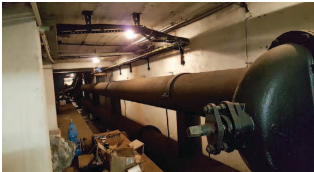
Rysunek 92. Widok skorodowanych rur wodociągowych wykonanych ze stali na SUW SOŁA I w Kobiernicach. Stan z 2015 r. tuż przed przystąpieniem do ich wymiany na rury ze stali szlachetnej (nierdzewnej, kwasoodpornej) [źródło: materiały archiwalne AQUA S.A.].
