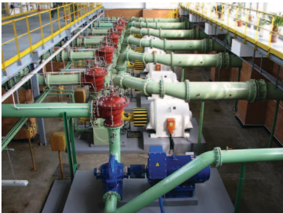
Rysunek 33. Pompownia G na ujęciu SOŁA III (stan z okresu lat 2010–2018) [źródło: materiały archiwalne AQUA S.A.].
