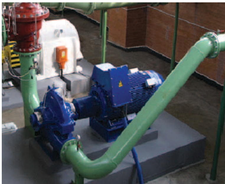
Rysunek 82. Nowa pompa KSB typu OMEGA zabudowana na pompowni G w Kobiernicach dla optymalizacji jej wydajności i poprawy kosztów eksploatacji [źródło: materiały archiwalne AQUA S.A.].
