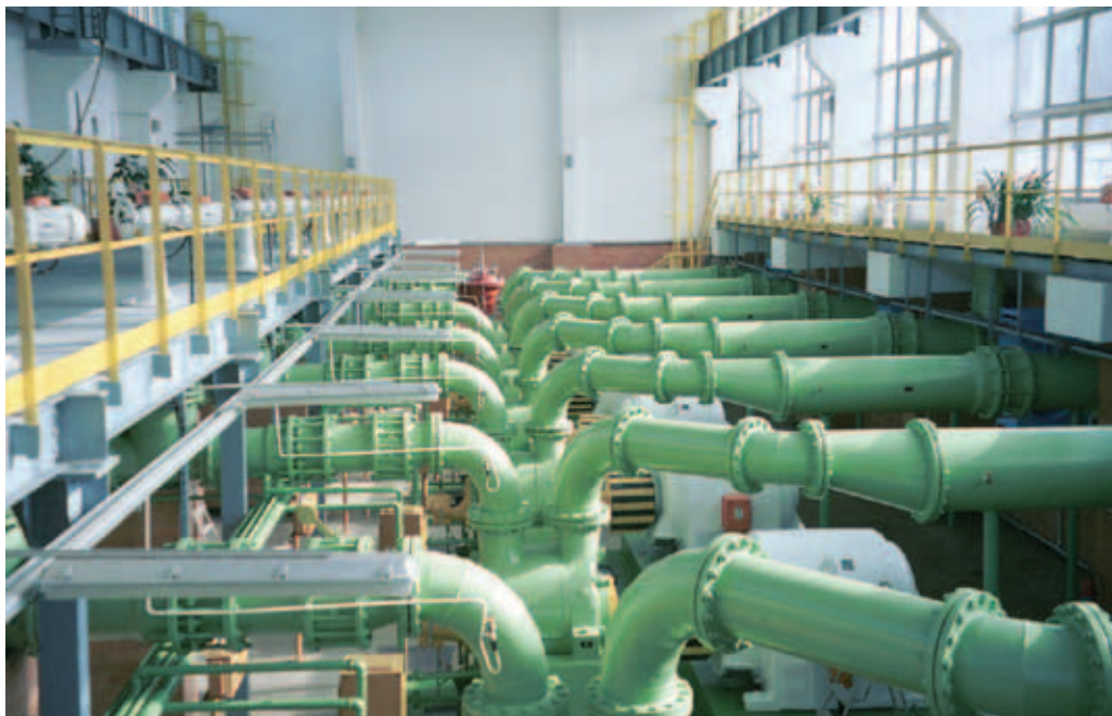
Rysunek 81. Widok pompowni G w Kobiernicach w trakcie testów eksploatacyjnych kątownego zaworu membranowego zainstalowanego w celu ochrony pompy G_7 typu 35W50 (w głębi – oznaczonego kolorem czerwonym; stan z 2001 r.) [źródło: materiały archiwalne AQUA S.A.].
