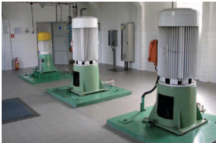
Rysunek 87. Pompownia niskiego ciśnienia B – poziom silników. W głębi nowa pompa typu 30D22 [źródło: materiały archiwalne AQUA S.A.].
