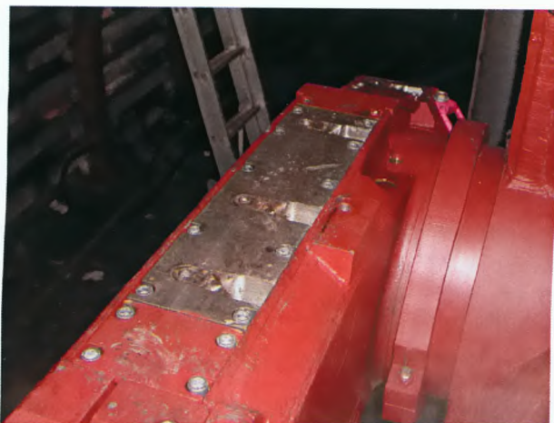
Rys.41. Widok na baterię dysz zraszających powietrzno-wodnych
