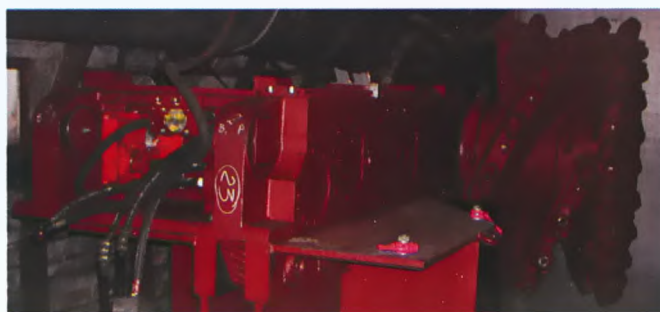
Rys.40. Widok ramienia z instalacją zraszającą od strony organu
