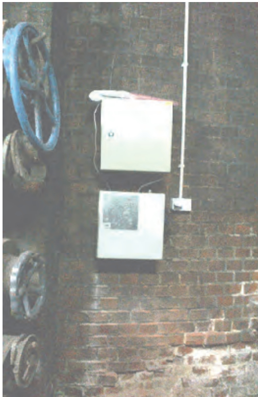
Fot. 9.2.1. Miejsce zainstalowania czujnika
