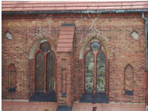
Fot. 9.5.2. Elewacja budynku kościoła od strony zachodniej – spękania ściany zewnętrznej nawy głównej (Mika, Ferenc i Czaja, 2018)
