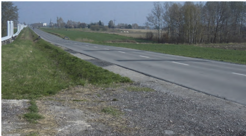
Fot. 5.2.1. Niecka o maksymalnym obniżeniu 3,6 m wzdłuż drogi Stefanów – Nadrybie
