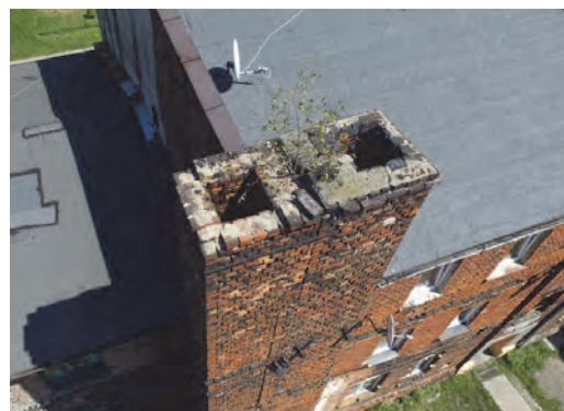
Fot. 9.5.5. Uszkodzona głowica kominu budynku (Mika, Ferenc i Czaja, 2018)
