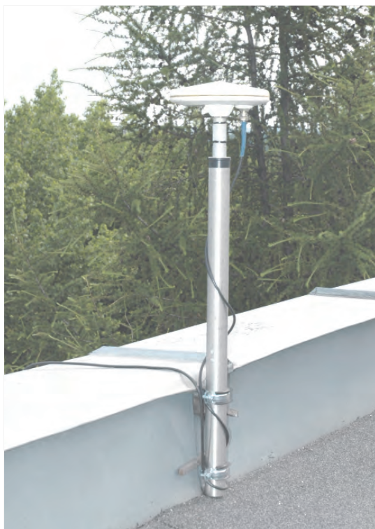
Fot. 9.3.1. Antena odbiornika GPS na dachu budynku (Jaśkowski, 2018)
