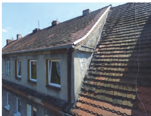
Fot. 9.5.4. Uszkodzenie dachówek budynku (Mika, Ferenc i Czaja, 2018)
