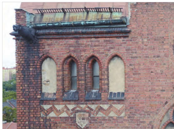
Fot. 9.5.3. Elewacja wieży kościoła od strony południowej – ubytek tynku ściany w górnej części wieży (Mika, Ferenc i Czaja, 2018)
