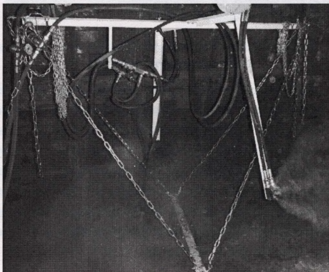
Rys. 9.20. Instalacja zraszająca podczas prób obmywania - widok z boku [51]
