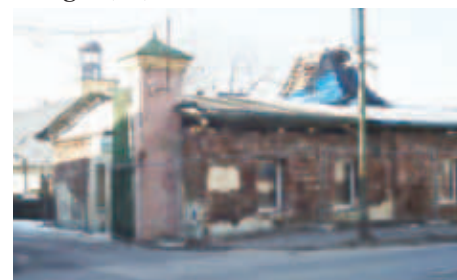
Budynek dawnej oficyny pałacowej Koszęcinie (tzw. „spalotka”) został skreślony z rejestru zabytków.
