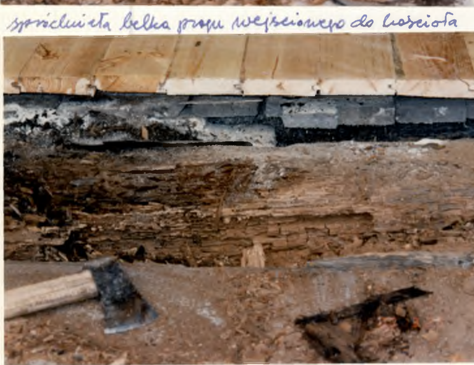
Belka: 40 x 20 cm w miejscu łosciota przypięta spróchniała - w jej miejsce wstawiliśmy belkę ielbetonową.
